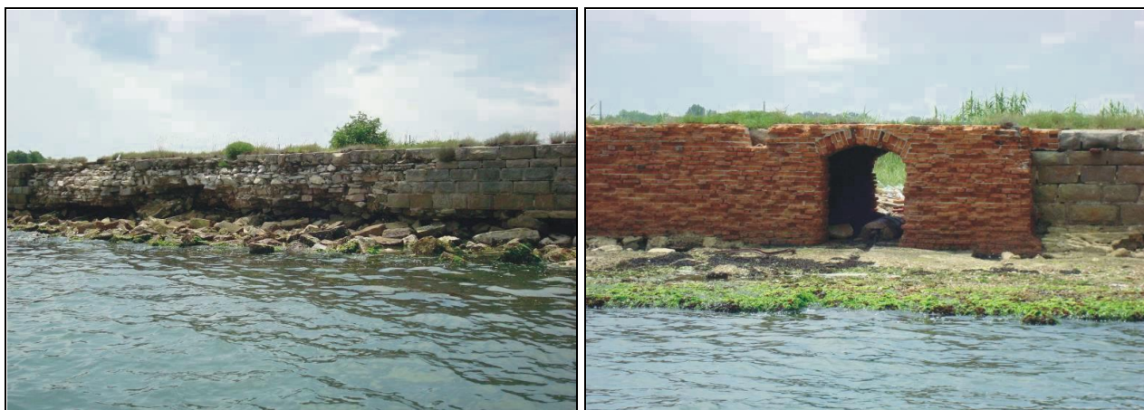
Figura 3.30 - Immagini della diga sud di Lido e del retrostante vecchio muro.
