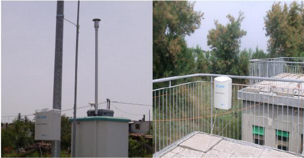
Fig. 3.2 - Stazione misura dei gas ETL2000 a Punta Sabbioni (sinistra) e a Malamocco (destra).
