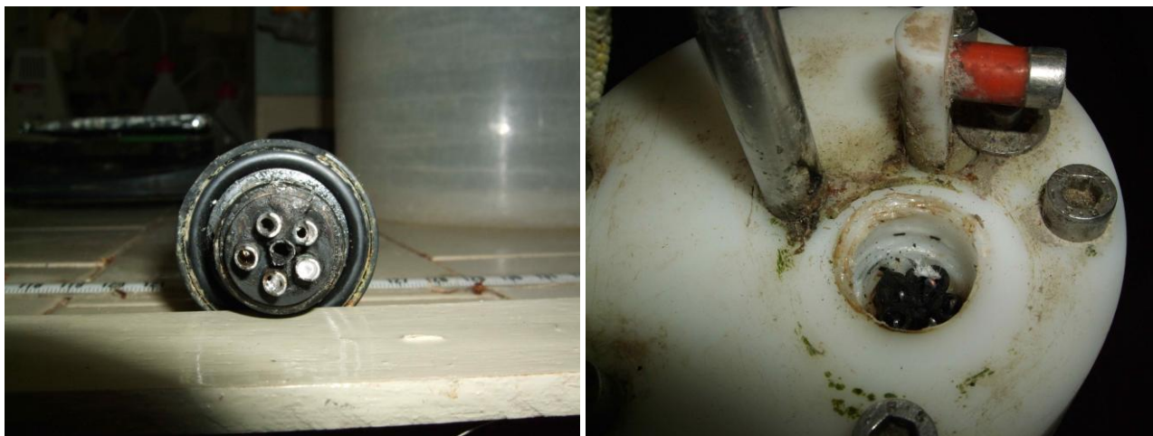
Figura 1.6 Esempio di danno alla testata della sonda nella stazione CHP: le saldature di collegamento del cavo di trasmissione dati tra la sonda ed il PC si sono irrimediabilmente danneggiati (fusione del conduttore probabilmente a seguito di corto; 20 novembre 2008).
