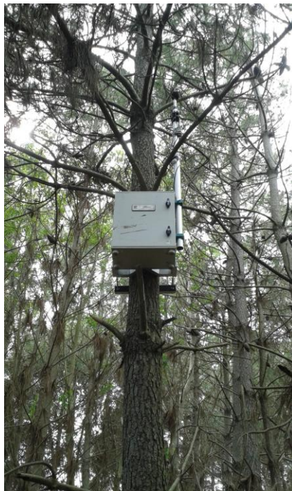
Figura 3. Foto della centralina di monitoraggio.
