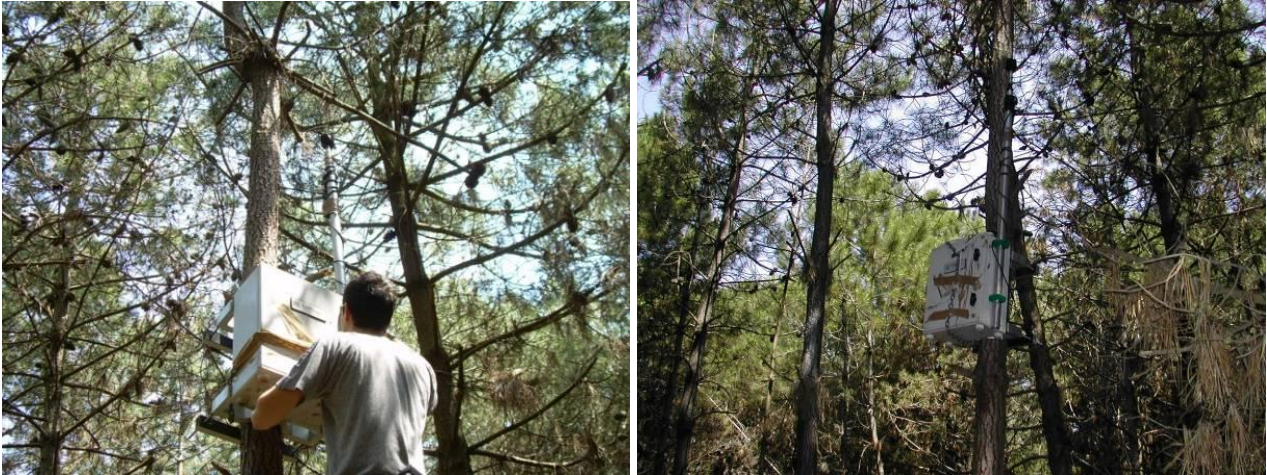
Figura 23: Foto della centralina di monitoraggio. Foto scattate, rispettivamente, in data 15 Maggio 2008 ed in data 10 Luglio 2008
