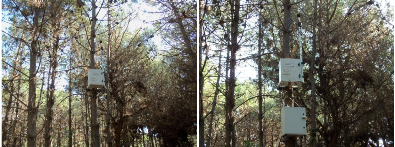
Figura 3: foto della centralina di monitoraggio, scattate il 10 Maggio (sinistra) e il 21 Giugno (destra) . In quest'ultima foto il secondo box visibile al di sotto della centralina è stato utilizzato come contenitore per le batterie di alimentazione della centralina stessa.
