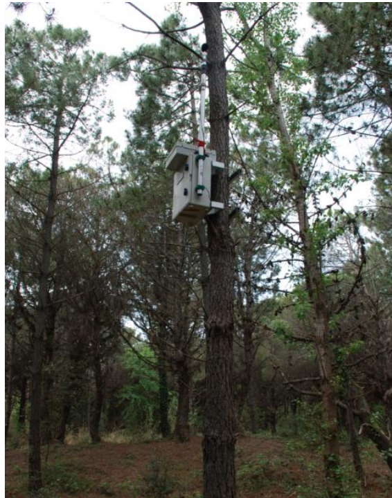
Figura 17: Centralina di monitoraggio
