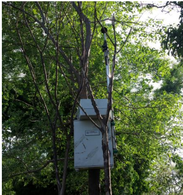
Figura 26: Foto della centralina di misura.
